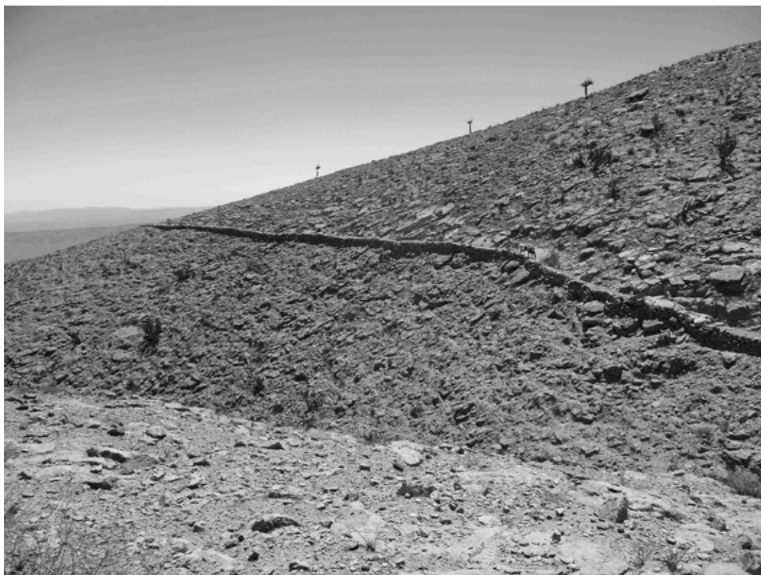
Figura 2. Tramo de la vía Belén-Ausipar con un muro de contención. Section of the Belén-Ausipar road with a retention wall.
